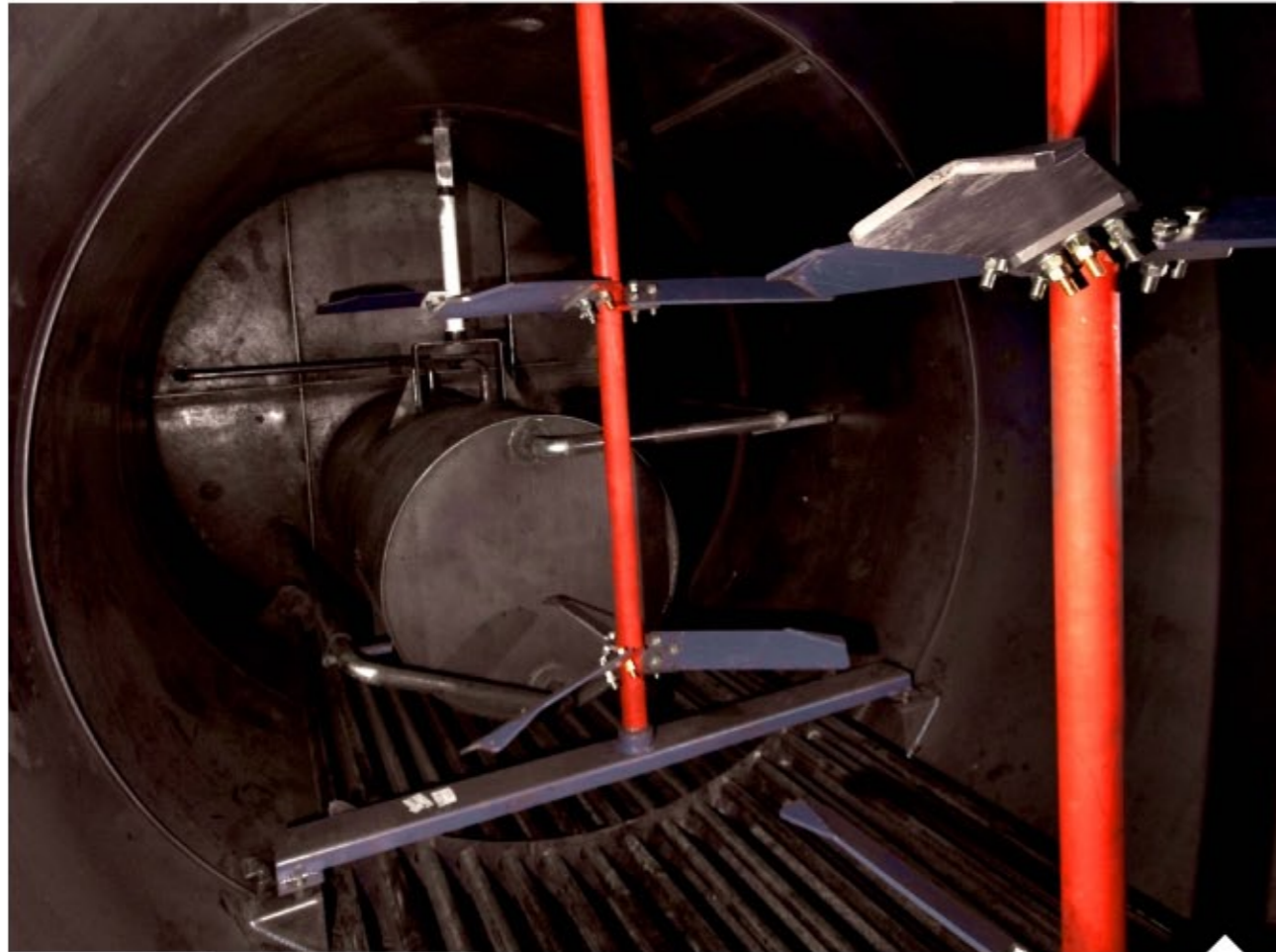
Serpentín de fluido térmico y agitadores
